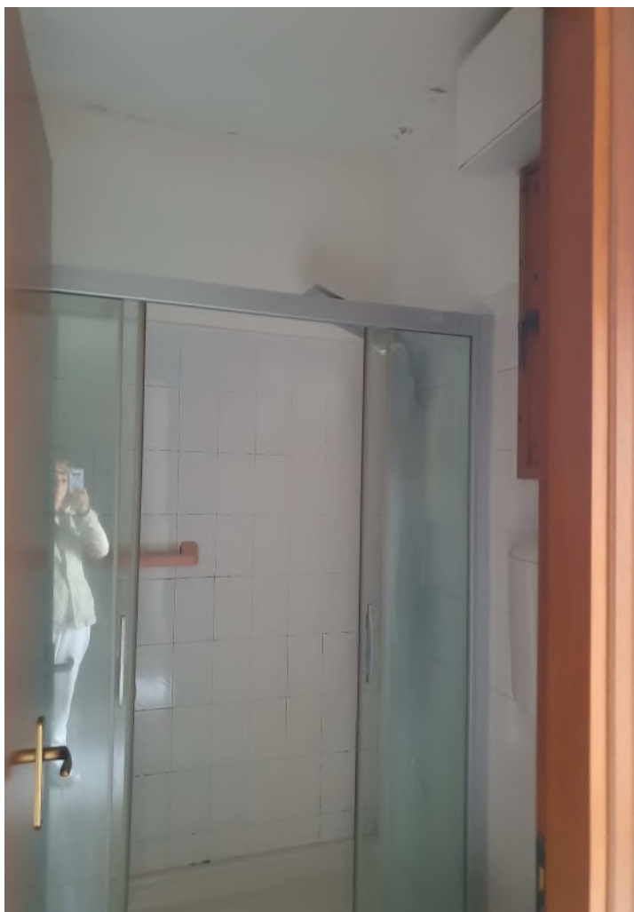
FOTO 14 : Camera singola: presenza di muffa sulla parete e sugli angoli
