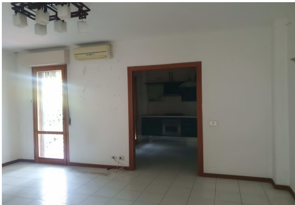
FOTO 1 - Ingresso/soggiorno: presenza di muffa negli angoli e vicino alle finestre
