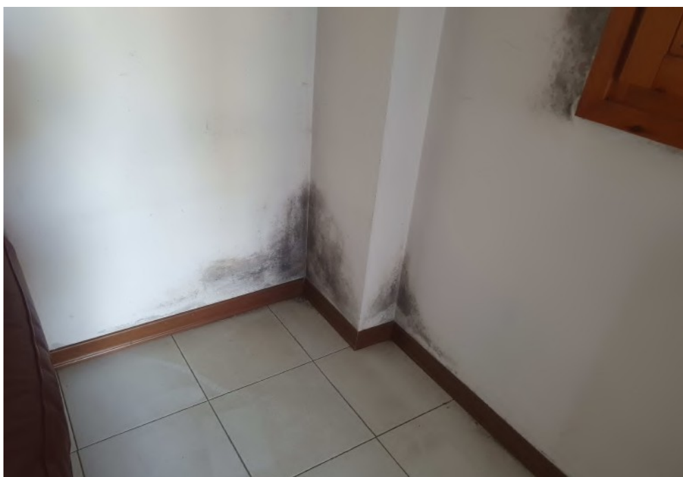
FOTO 2 - Soggiorno: presenza di muffa negli angoli e vicino alle finestre
