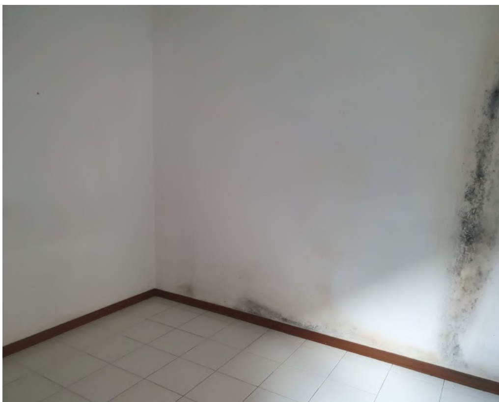
FOTO 12 - Camera matrimoniale 2: presenza di muffa sulla parete
