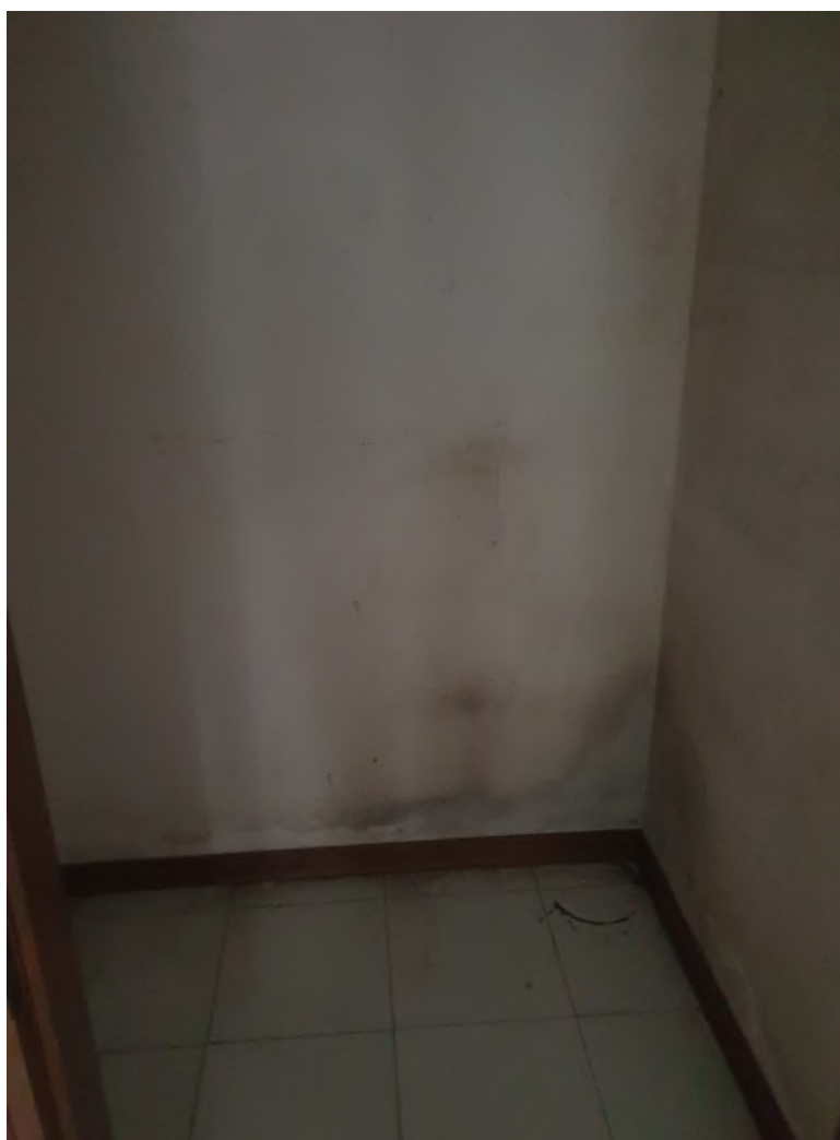
FOTO 9 - Ripostiglio: macchia di umidità angolo in basso
