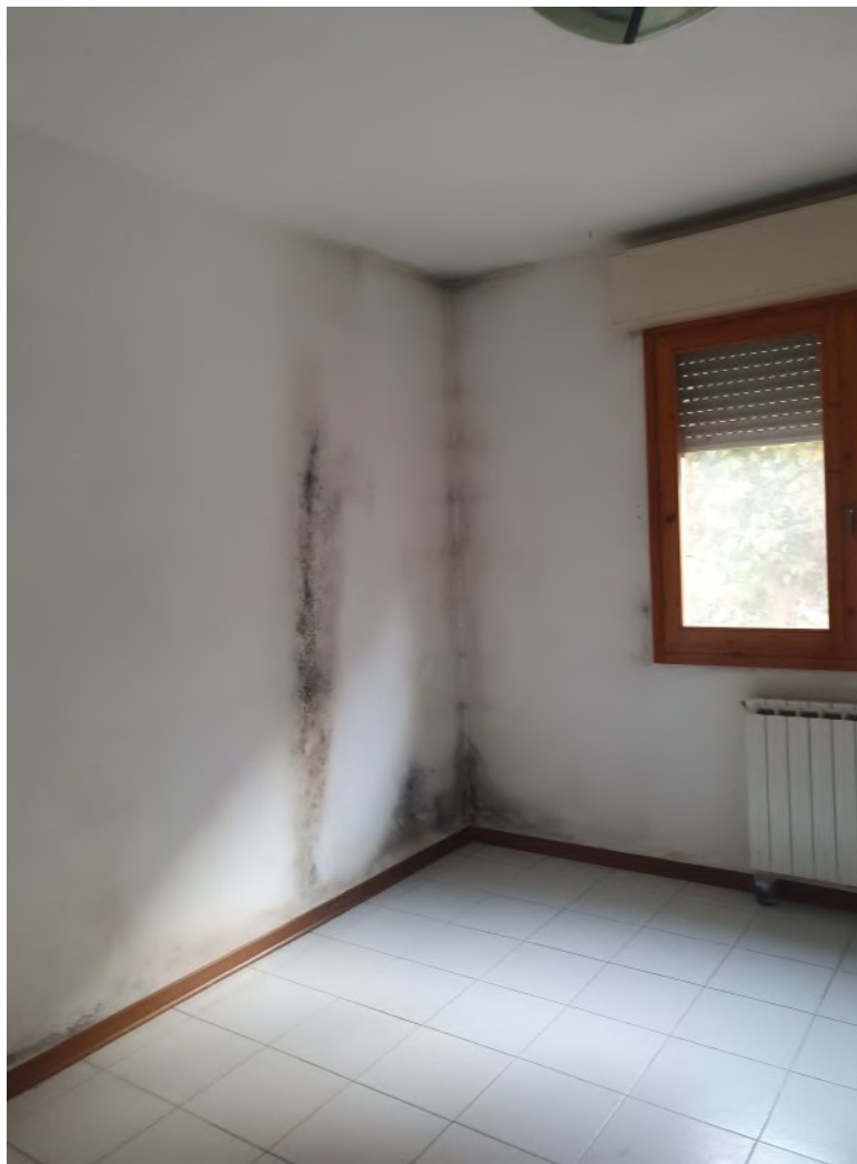
FOTO 11 - Camera matrimoniale 2: presenza di muffa sulla parete e nell'angolo
