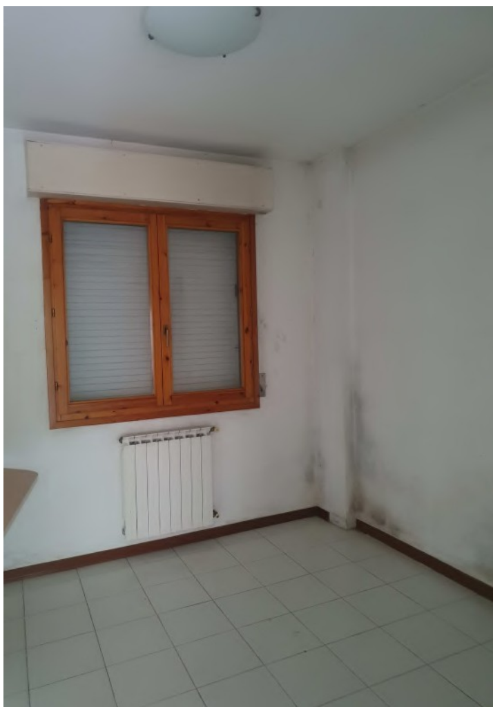
FOTO 13 - Camera singola: presenza di muffa sulla parete e sugli angoli
